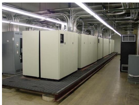
FIGURA 02: Exemplo de Sistemas de No-Breaks para empreendimentos hospitalares.
