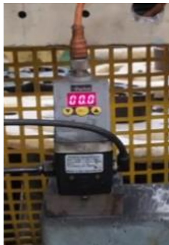
Figura 18: Válvula proporcional digital instalada
