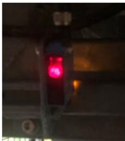
Figura 17: Sensor fotoelétrico instalado
