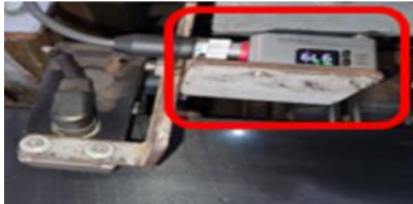
Figura 19: Sensor fotoelétrico instalado
