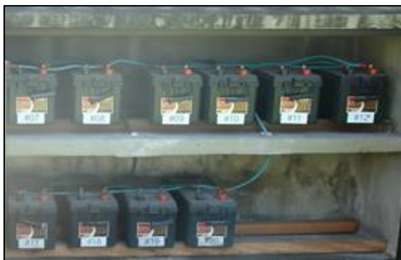
Figura 4. Banco de baterias. Fonte: Cresesb, 2013.
