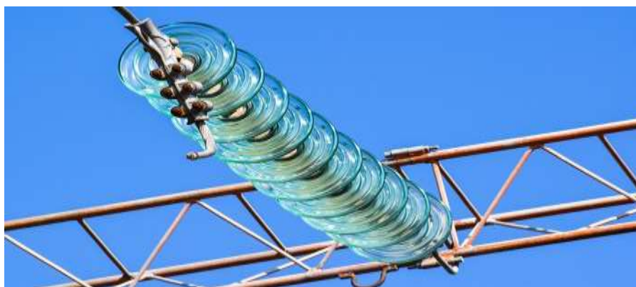
Figura 8 - Isolador de vidro do tipo disco
