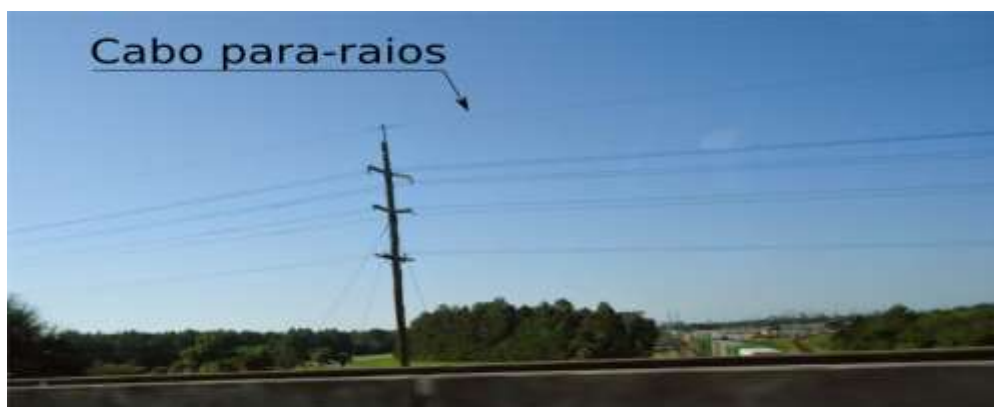
Figura 3 - Exemplo de Cabo para-raios
