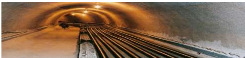
Figura 2 - Linha de transmissão subterrânea em São Paulo.
