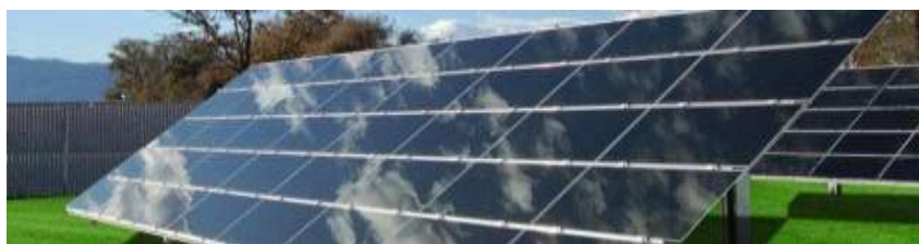
Figura 12- Módulos fotovoltaicos de filme fino de silício
